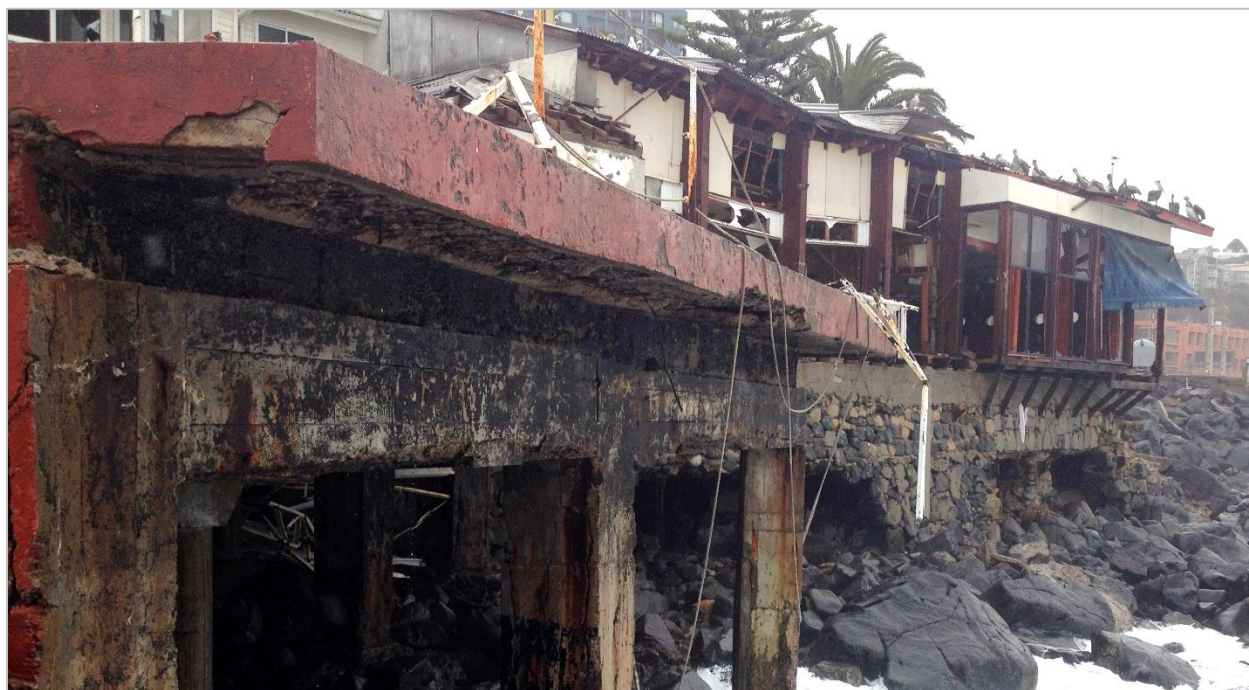
Figura 5 Socavación de las bases y destrucción de la superestructura de la sede del Club Caleuche, ubicado inmediatamente abajo del faro en la foto de la Figura 4.
